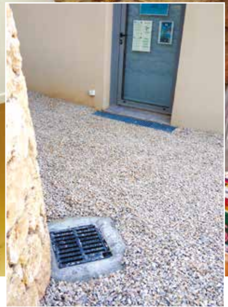
Canalisation et évacuation des eaux de pluie pour protéger la bibliothèque
